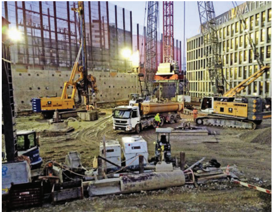
Bereits vor Baubeginn werden die geplanten Q-Kontrollen festgelegt: Baustelle Andreaesturm in Zürich-Oerlikon. Foto: Implemia.
