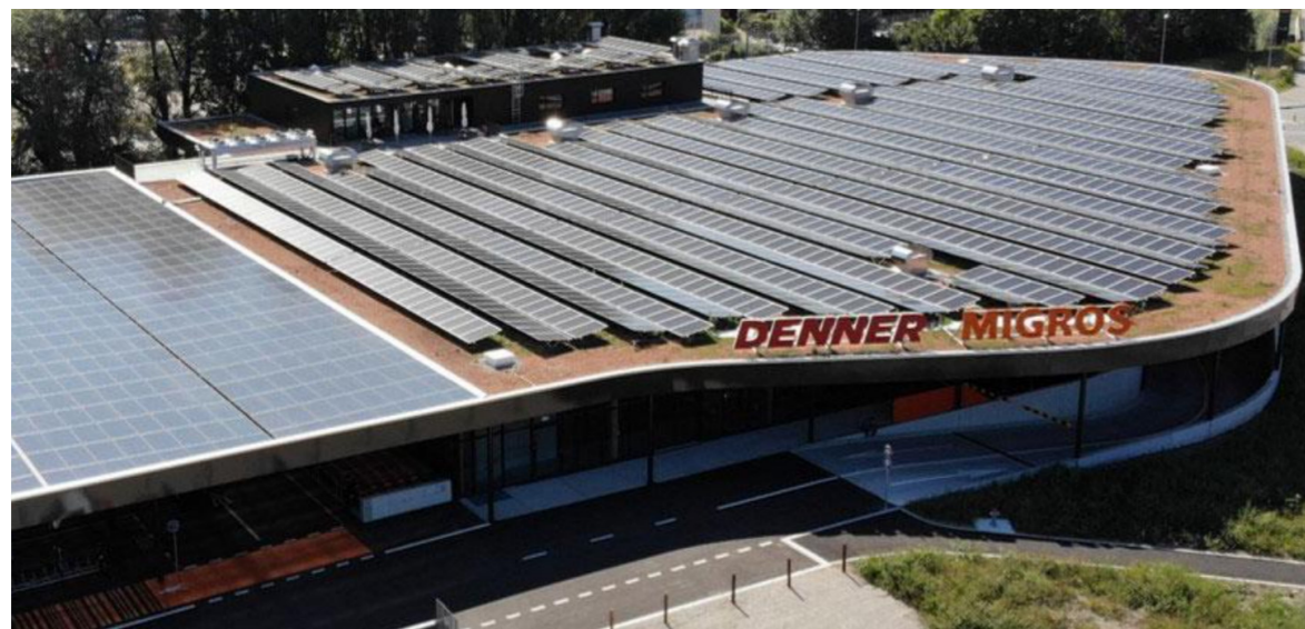
Abbildung 1: Photovoltaikanlage der Migros-Filiale in Schlieren - Rietbach mit einer DC-Leistung von 800 kWp. (Quelle: migros.ch)
