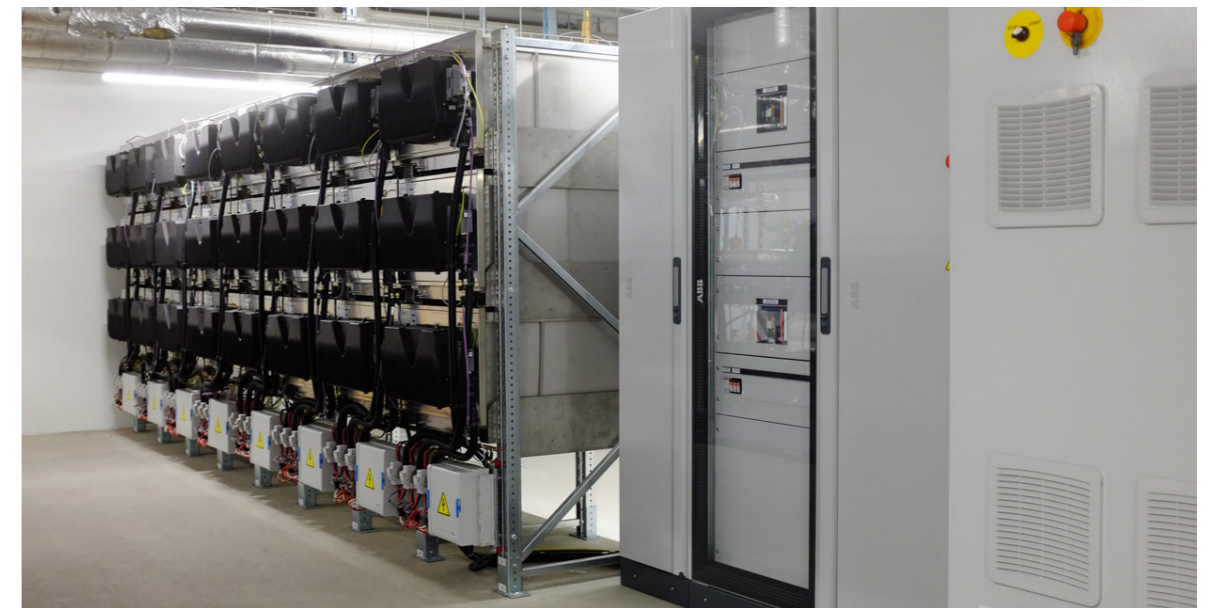
Abbildung 2: Modular aufgebauter Salz-Nickel-Speicher in der Migros-Filiale Schlieren - Rietbach mit einer Speicherkapazität von 540 kWh (Quelle: Innov.Energy)
