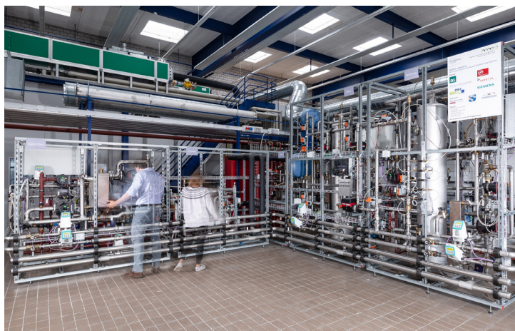
NODES-Lab (New Opportunities for Decentralized Energy Systems Laboratory) im Labor Gebäudetechnik, Hochschule Luzern – Technik & Architektur, Horw
