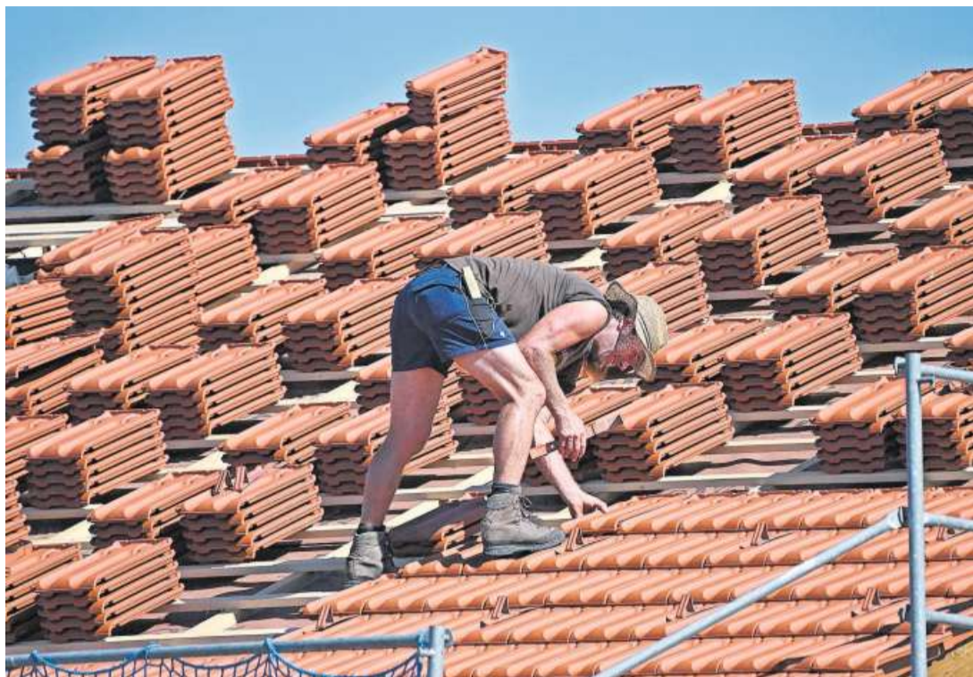
Eine Renovation des Daches lohnt sich in Basel nur noch, wenn dieses undicht ist.
