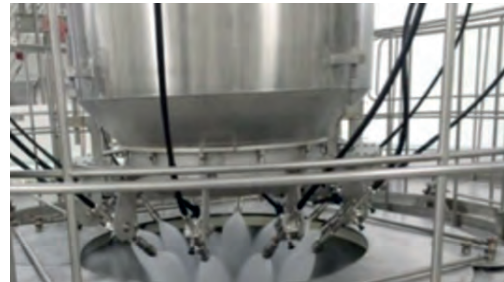
Abb. 2: Kreisförmige Anordnung der Sprühdüsen um die Trocknungskammer
