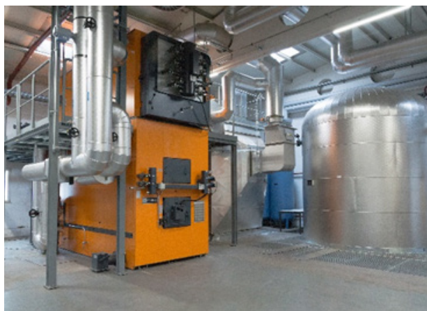
Abb. 1: Monovalente Holzfeuerung mit Speicher
