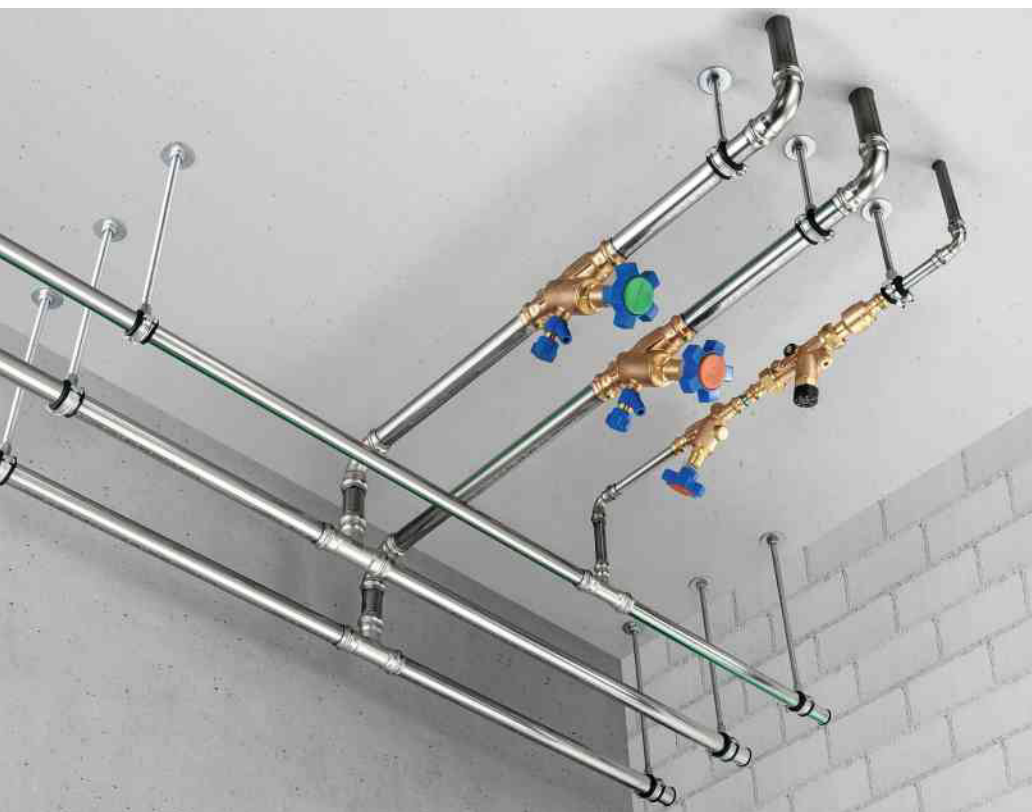
Der Werkstoff-Mix für Kellerverteilungen und Steigleitungen umfasst Edelstahl- und/oder Mehrschichtverbundrohre. Bei Armaturen kommen oft Kupfer-Legierungen oder Edelstahl zum Einsatz. (Bild: R. Nussbaum AG, Optipress-Aquaplus)
