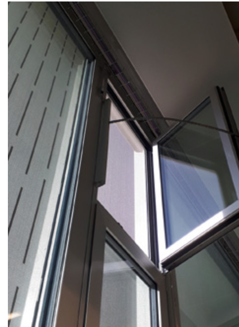
Abb. 5: Lüftungsflügel einer Nachtlüftungsanlage.
