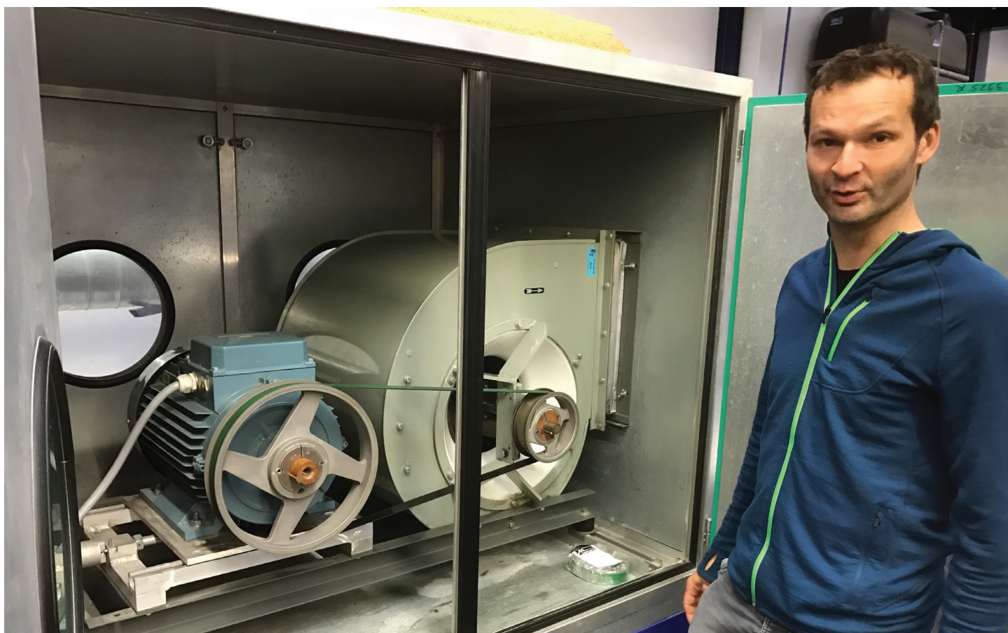
HSLU-Forscher Christoph Dahinden mit einem Lüftungsventilator im Forschungslabor des Zentrums für Integrale Gebäudetechnik in Horw bei Luzern. Die Antriebsenergie des Elektromotors wird mit einem Keilriemen auf den Ventilator übertragen. Foto: B. Vogel
