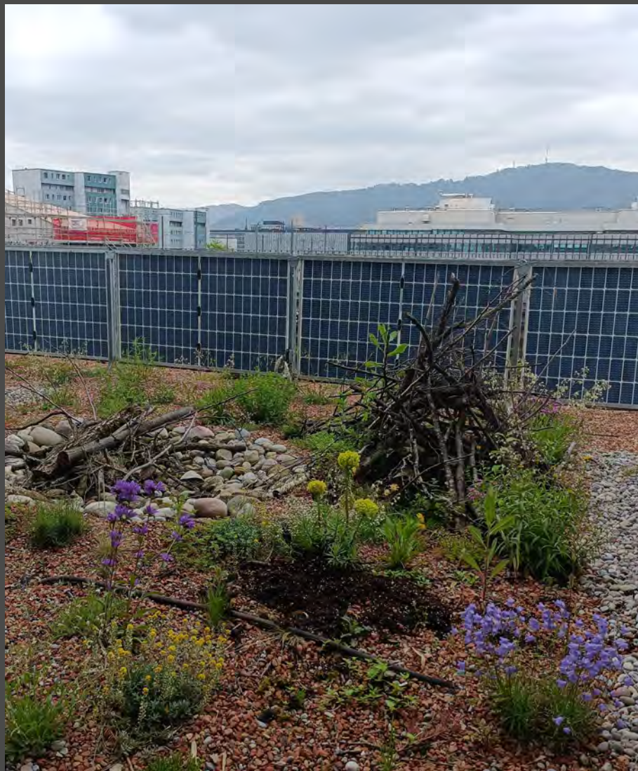
Senkrechte, bifaziale Solaranlage, ZKB
