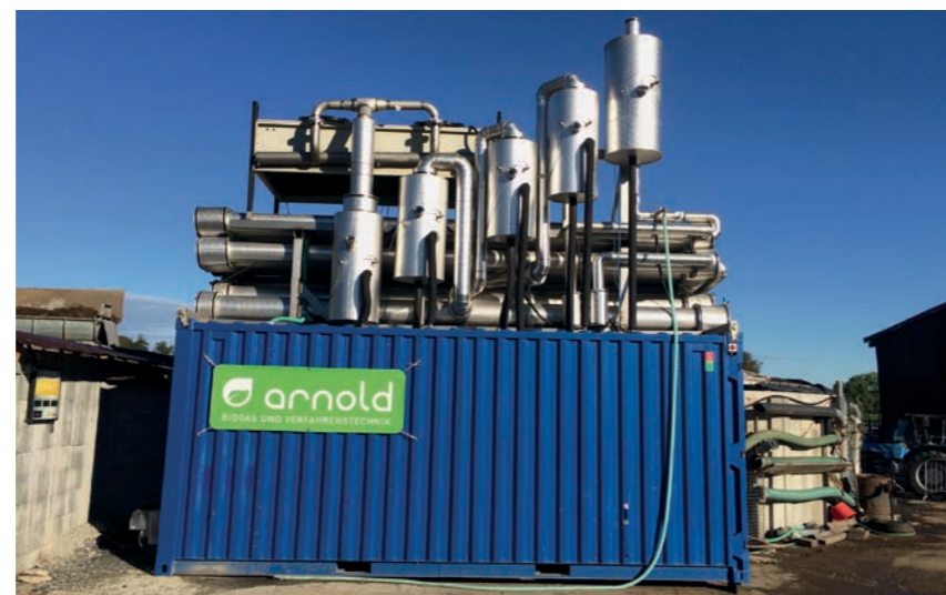
Die Eindampf-Anlage auf dem Betrieb von Georges Martin in Puidoux VD. Der Landwirt hat 2014 für die mit der Arnold & Partner AG entwickelte Anlage den Agro-Spezialpreis erhalten.
