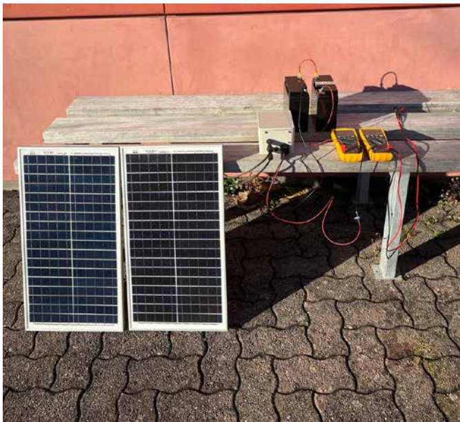
Abb. 2: Messaufbau des DC-Microgrids im Freien
