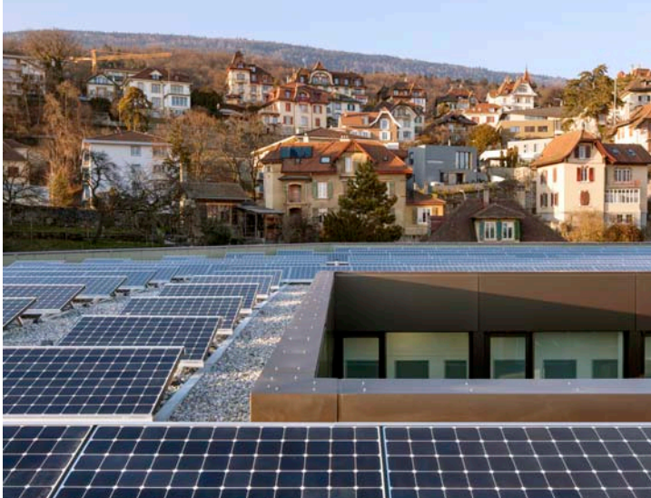
Erneuerbare Energien | Photovoltaikmodule des Solardachs (Foto Y. André)
