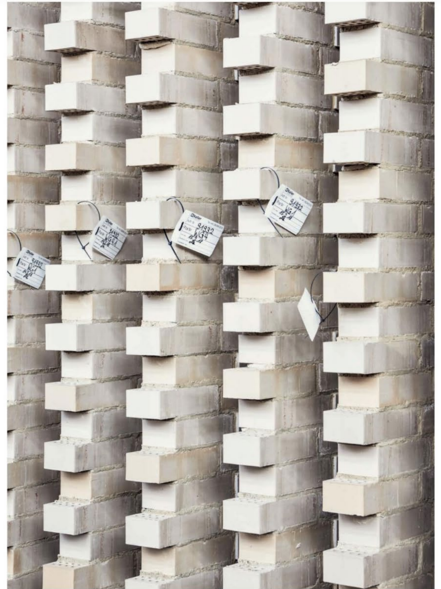
Vorgefertigte Massivmauerelemente müssen «just in time» auf der Baustelle eintreffen, abgestimmt auf die Versetzreihenfolge des Bauablaufs.
