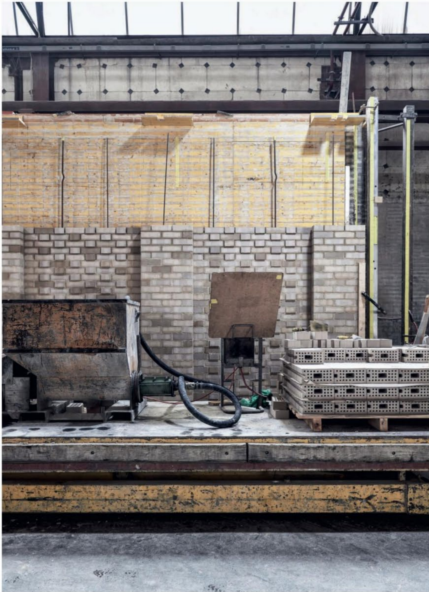
An einer schrägen Wand fädeln Maurer die gelochten Steine mit Nut an zwei Transportankern ein. Lageweise tragen sie Pumpmörtel auf und pressen ihn in die Stossfugen.
