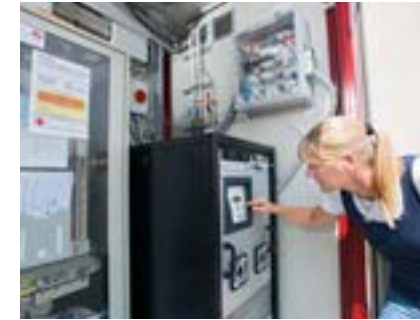
... bei der Kontrolle der Betriebsdaten.
