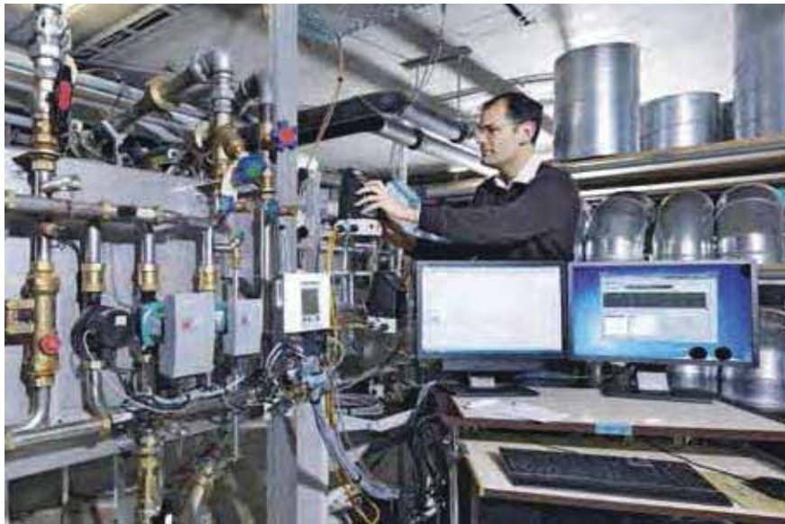
Der Projektleiter Benoit Sicre testet die neu entwickelte Regelung der Frischwasserstation.
