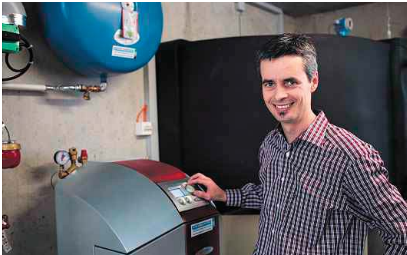
Intensive Messungen im Keller: Beat Wellig testet die Luft/Wasser-Wärmepumpe unter realen Bedingungen – bei sich zu Hause.
